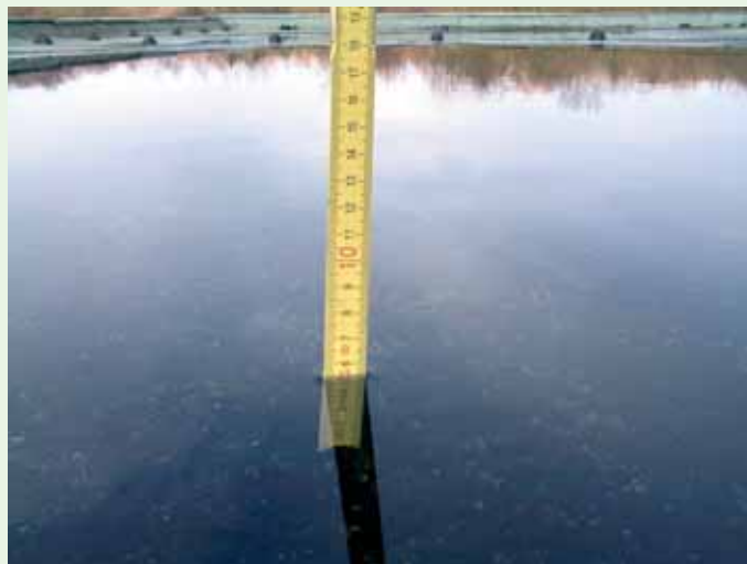
Abb. 12: Wassersackbildung auf dem Flachdach des Schneverdinger Bürgersaals
