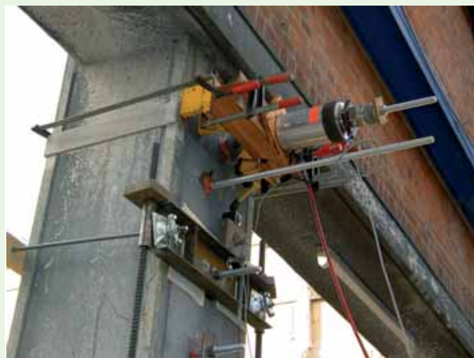
Abb. 10: Belastungsvorrichtung für die Klebedübel
