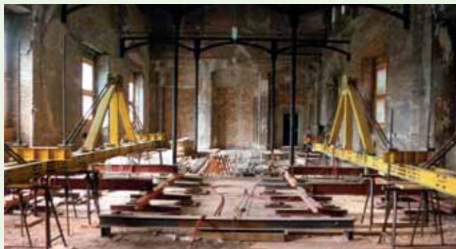
Abb. 18: Belastungsversuche an einer Mehrfeld-Tonnenecke des Berliner Museums
