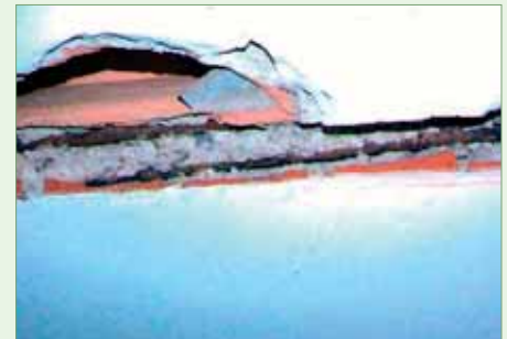
Abb. 7: Baufehler fehlender Betondeckung
